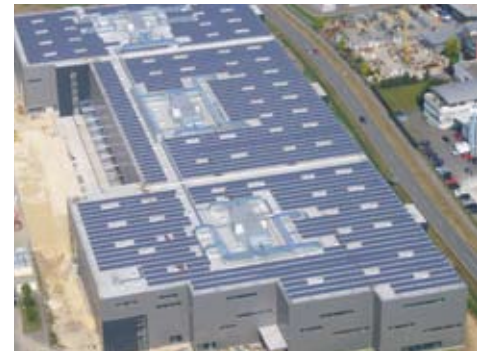
Installation 1 MW, installation sur toiture (Allemagne) Impianto 1MW, su tetto (Germania)
