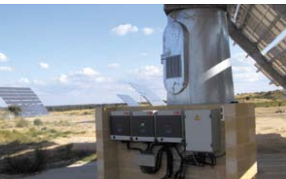
Installation 400 kW, système à régulateur (Espagne) Impianto 400kW, sistema Tracker (Spagna)
